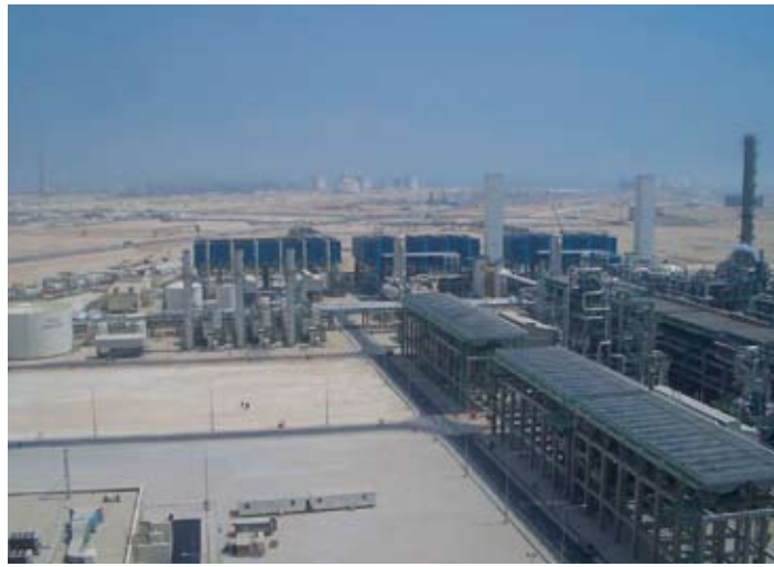
Nuevos combustibles: Enfriadores de aire con aspas y Aerocondensadores (ACC) instalados en la planta de conversión de gas a líquidos "GTL - Gas to Liquids", manufacturado por Batignolles Technologies Thermiques
