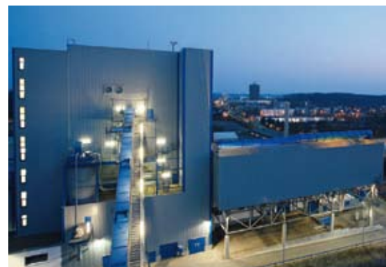
Bergkamen planta de energía de biomasa: Aerocondensador (ACC) diseñado y manufacturado por GEA Energietechnik
