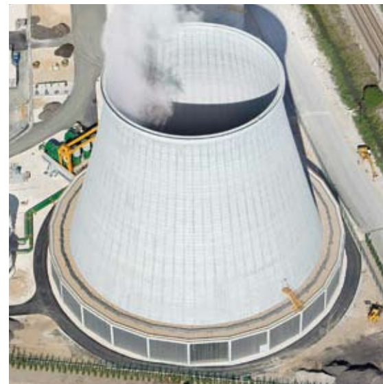
Torre de enfriamiento de tiro natural asistido por ventiladores, instalado en la planta de energía de Ribatejo en Portugal
