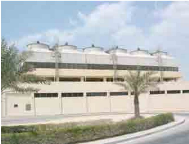
Torre de enfriamiento modelo CMDR 630 Plaza comercial en Dubai.
