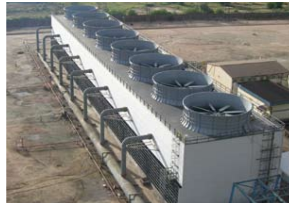
Torre de enfriamiento de contra flujo "Planta Termoelectrica - Francisco Pérez Ramos - Unidad 3" ubicada en Tula Hidalgo, México con capacidad de 100,000 GPM fabricada en FRP.
